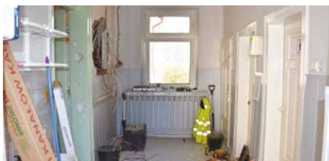
Przedskole w Dzięgielowie – przed remontem
