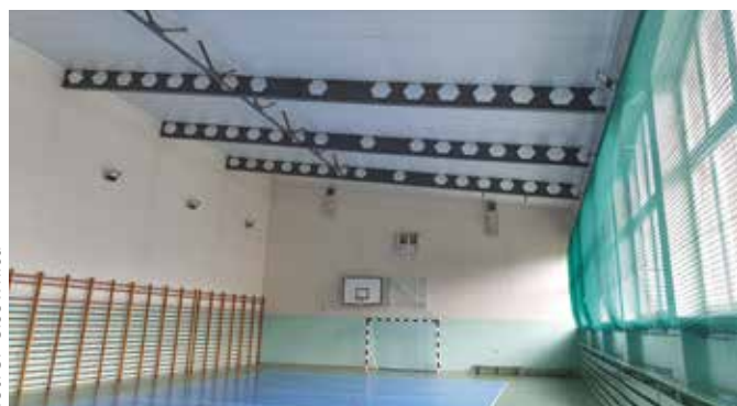
SP Cisownica - oświetlenie LED na sali gimnastycznej
