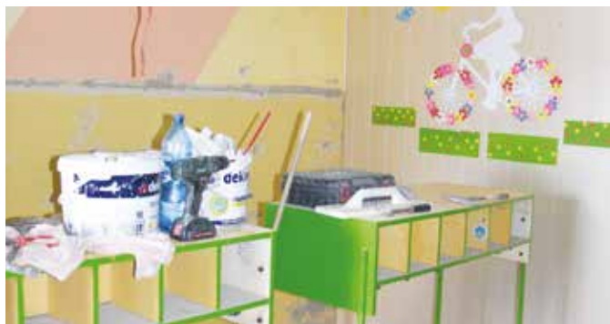
Przedskole w Dzięgielowie – przed remontem
