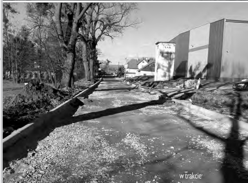
Bażanowice – droga przed remontem
